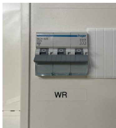
Abbildung 2 – Sicherungen im Zählerschrank/Schaltschrank
