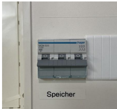
Abbildung 2 – Sicherungen im Schaltschrank/Zählerschrank
