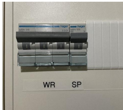
Abbildung 2 – Sicherungen im Schaltschrank/Zählerschrank
