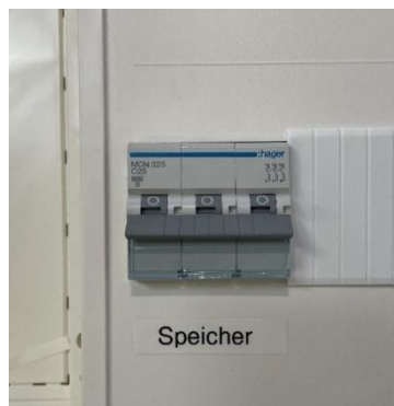
Abbildung 2 – Sicherungen im Schaltschrank/Zählerschrank
