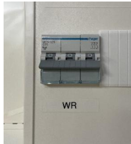
Abbildung 3 – Sicherungen im Schaltschrank/Zählerschrank
