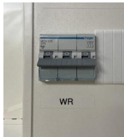
Abbildung 3 – Sicherungen im Schaltschrank/Zählerschrank
