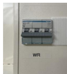
Abbildung 3 – Sicherungen im Schaltschrank/Zählerschrank
