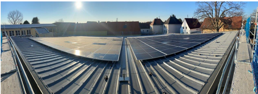
Blick auf die PV-Anlage auf dem Dach der Grundschule Böhl.
