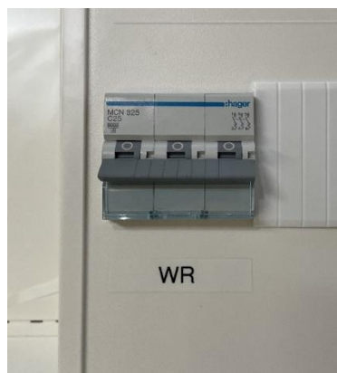
Abbildung 2 – Sicherungen im Zählerschrank/Schaltschrank
