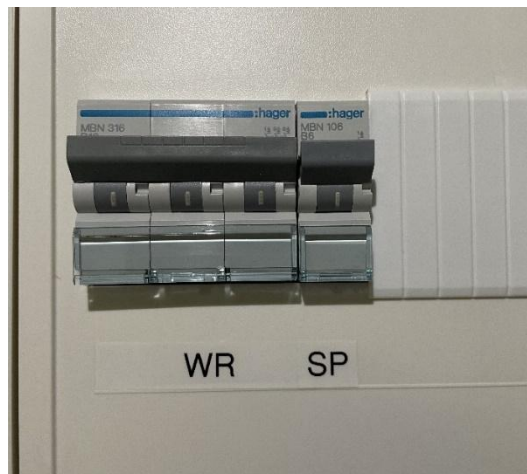
Abbildung 2 – Sicherungen im Schaltschrank/Zählerschrank
