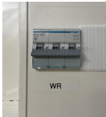
Abbildung 2 – Sicherungen im Schaltschrank/Zählerschrank
