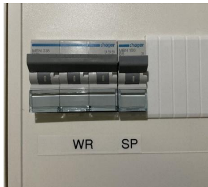
Abbildung 2 – Sicherungen im Schaltschrank/Zählerschrank
