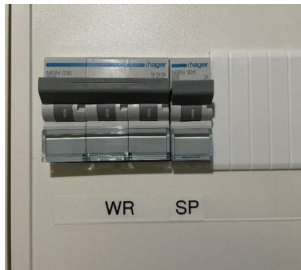
Abbildung 2 – Sicherungen im Schaltschrank/Zählerschrank
