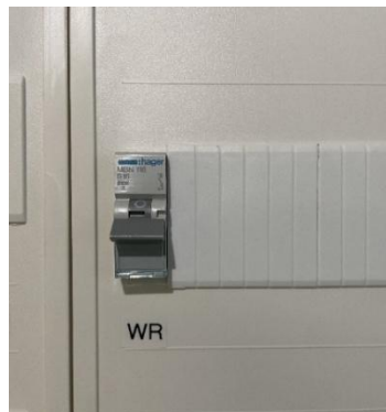
Abbildung 2 – Sicherung im Schaltschrank/Zählerschrank
