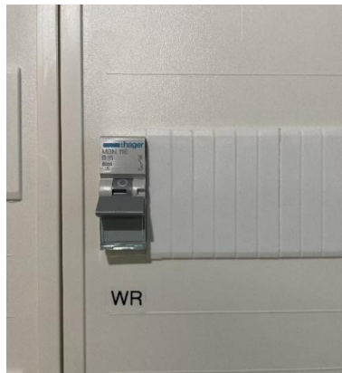
Abbildung 2 – Sicherungen im Schaltschrank/Zählerschrank
