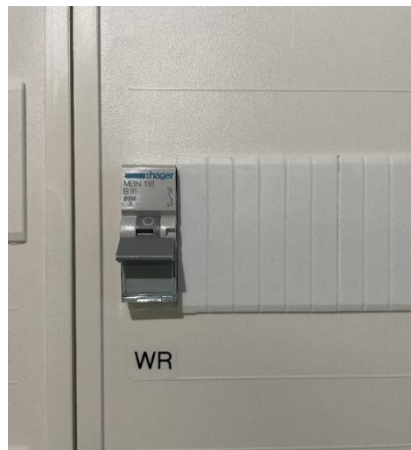
Abbildung 2 – Sicherung im Schaltschrank/Zählerschrank
