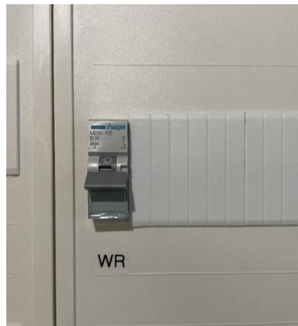
Abbildung 2 – Sicherung im Schaltschrank/Zählerschrank
