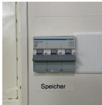
Abbildung 2 – Sicherungen im Schaltschrank/Zählerschrank
