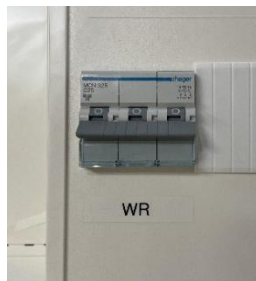
Abbildung 3 – Sicherungen im Schaltschrank/Zählerschrank
