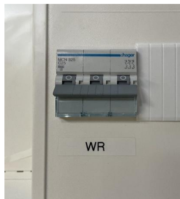
Abbildung 2 – Sicherungen im Schaltschrank/Zählerschrank
