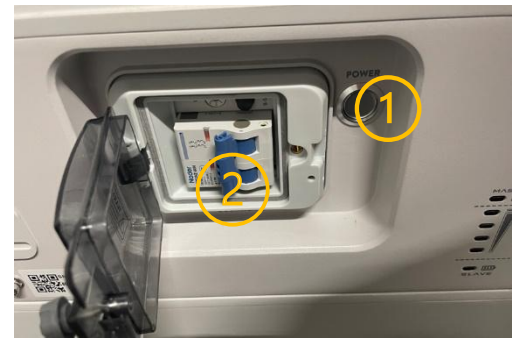
Abbildung 3 – Schalter und Sicherungen am Speicher
