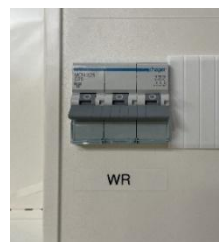
Abbildung 4 – Sicherungen im Schaltschrank/Zählerschrank
