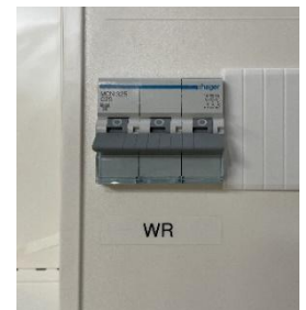
Abbildung 9 – Sicherungen im Schaltschrank/Zählerschrank
