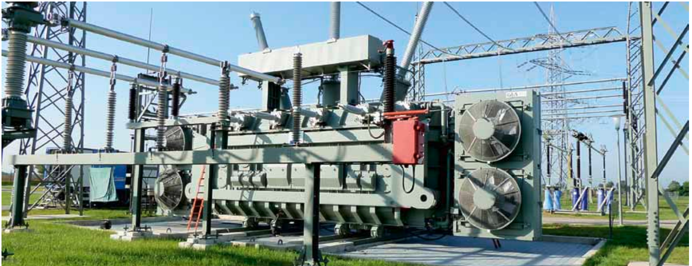
UMSPANNANLAGE WEINGARTEN: eine Investition ins moderne Stromnetz und in den Wirtschaftsstandort
